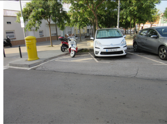
Acumulació d'aigua en la cantonada de la vorera d'una zona d'aparcament al carrer de les Margarides. Aquestes petites afeccions són el tipus de "problemes" que té el drenatge de pluvials al barri d'Albarrosa.
