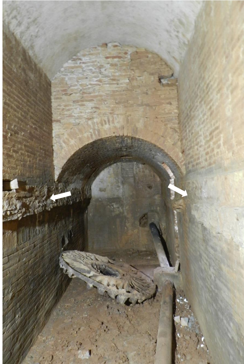
Carcabà de la bassa inferior on s'indica el testimoni de l'antic sòl seccionat existent abans de la reforma, per tal d'encabir el nou carcabà
