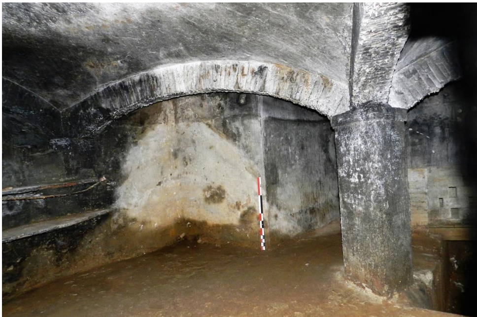
Mur en angle aparegut darrera la runa que podria amagar el desguàs per traspasar l'aigua a la sala adjacent inferior.
