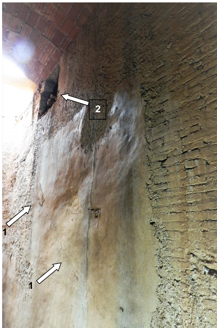
Empremta de la roda (1) al mur sud i entrada de la caiguda d'aigua (2)
