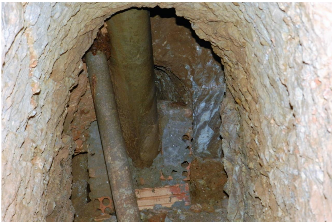
Extrem interior de la mina bloquejat per connexions fetes amb canonades de fibrociment
