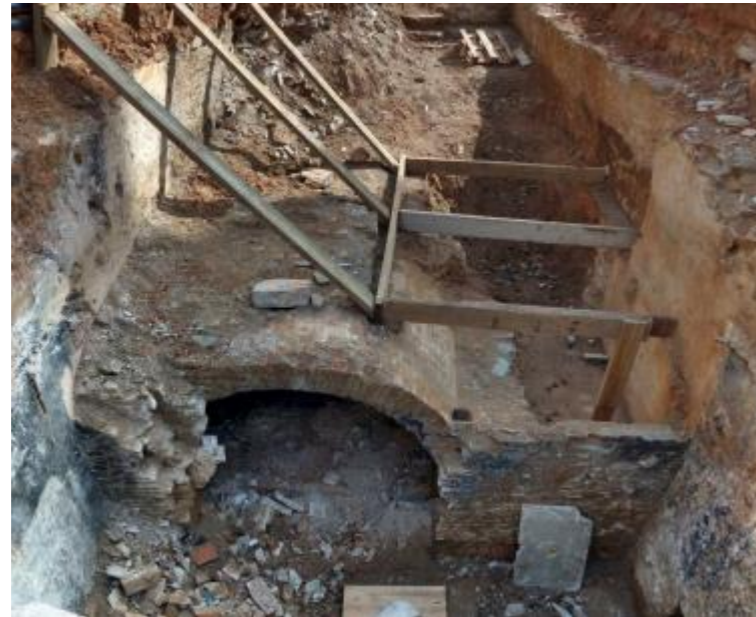
Figura 2. Vista exterior de la zona del carcabà inferior. S'observa l'aparent estat ruïnós del conjunt (document [c]) (Manuel Luengo estiu 2022)
