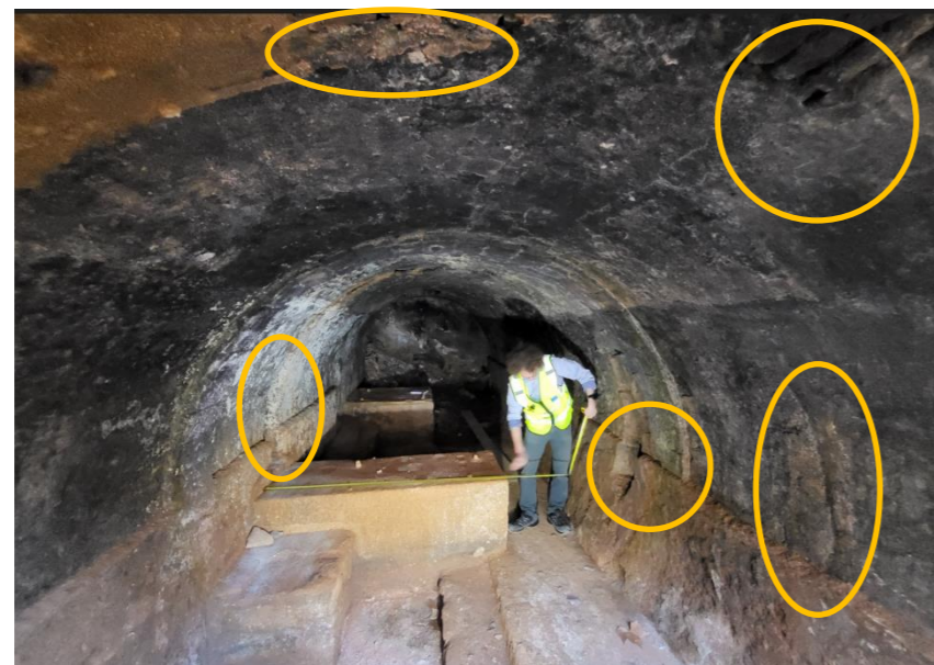
Figura 3. Irregularitats, no homogeneïtats de materials en la volta superior del carcabà inferior, pèrdues d'alineació de la fàbrica, esbombaments, discontinuïtats... detectades a data 29/11/2022.
