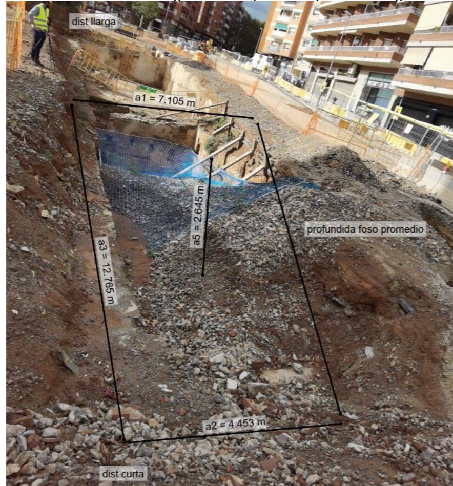
Figura 13. Rebliment en la zona del carcabà inferior. Aquest àmbit ha patit diverses actuacions de rebliment així com és patent el fet de que forts aiguats han aportat sediments i rebliments a aquest àmbit, fent que globalment la distribució del rebliment sigui heterogènia en quan a materials, distribució dels mateixos i en el perfil altimètric. Per aquest motiu es proposa executar tres terrasses on el seu fons sigui una plataforma homogènia per transferir uniformement les càrregues de la prova de càrrega minimitzant assentaments diferencials i inestabilitats.
