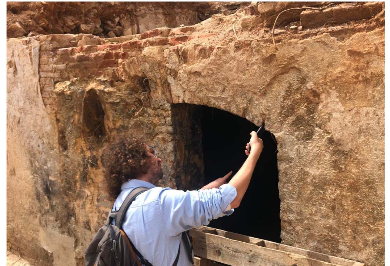
Figura 12. Vista exterior de la volta d'accés al carcabà superior on s'observa la presència de diverses patologies com esquerdes, descrostaments, eflorescències, discontinuïtat de materials, etc. Atès a que aquesta zona actuarà com a vora lliure és perceptiva una prova de càrrega empírica per esvair dubtes sobre la capacitat portant vistes les dificultats i incerteses d'una avaluació teòrica.
