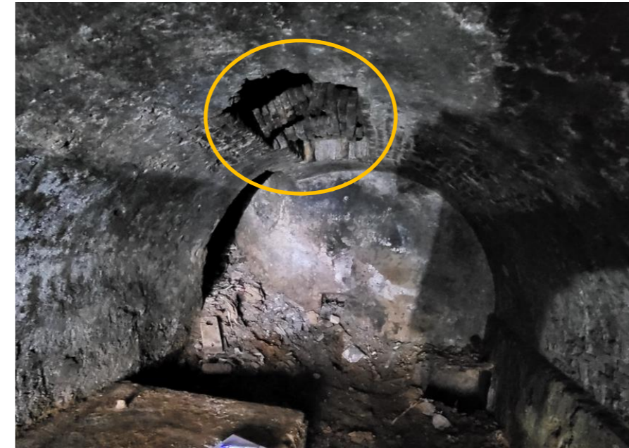
Figura 4. Col·lapse parcial de la volta superior del carcabà inferior, presència de runa i escombraries en rebliments entorn a l'estructura soterrada a data 29/11/2022.
