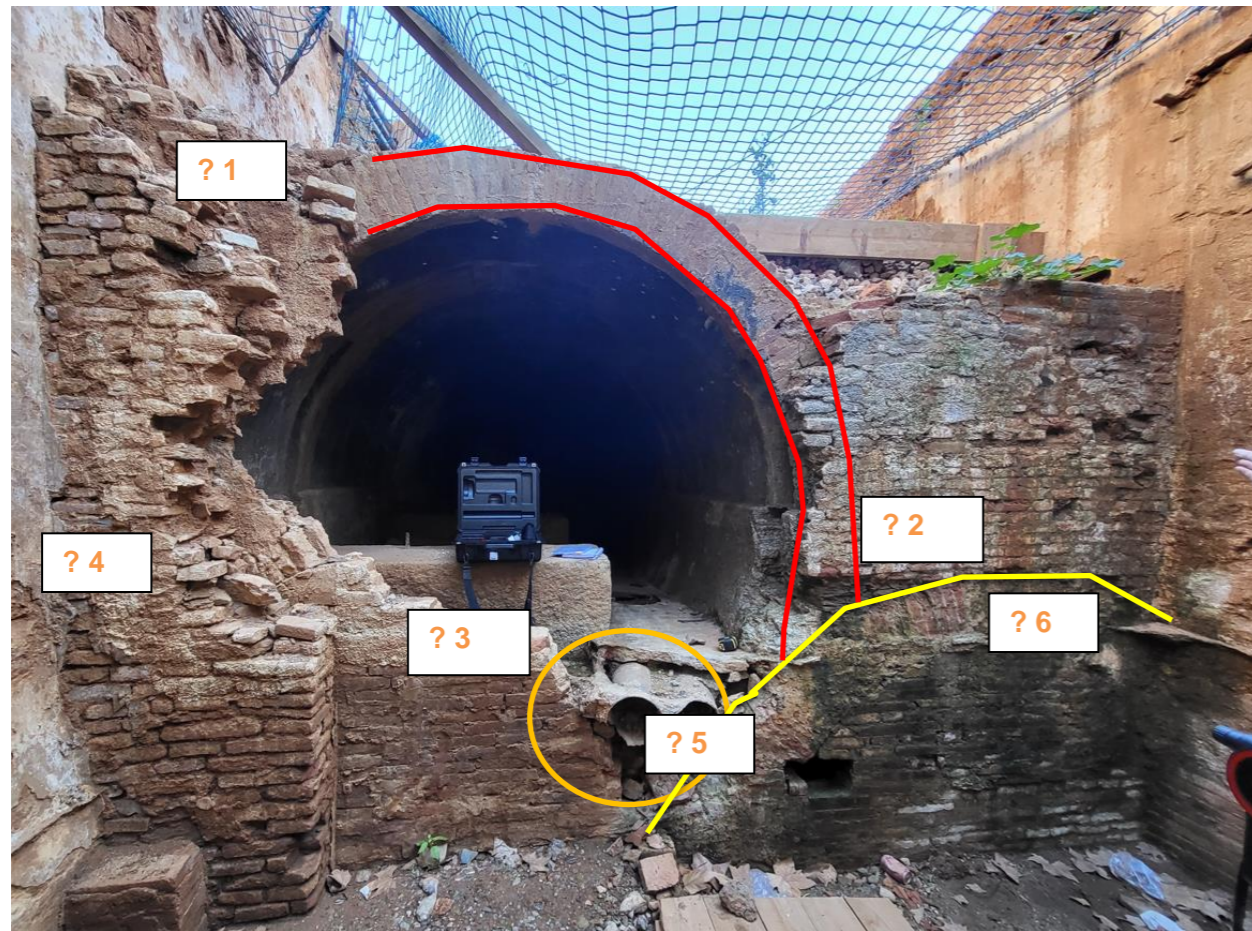
Figura 6. Estat ruïnós aparent de l'arrancada de la volta superior del carcabà inferior. S'observen com a mínim les següents incerteses, les quals afecten a la caracterització de materials i a la configuració del model geotècnic/estructural:
