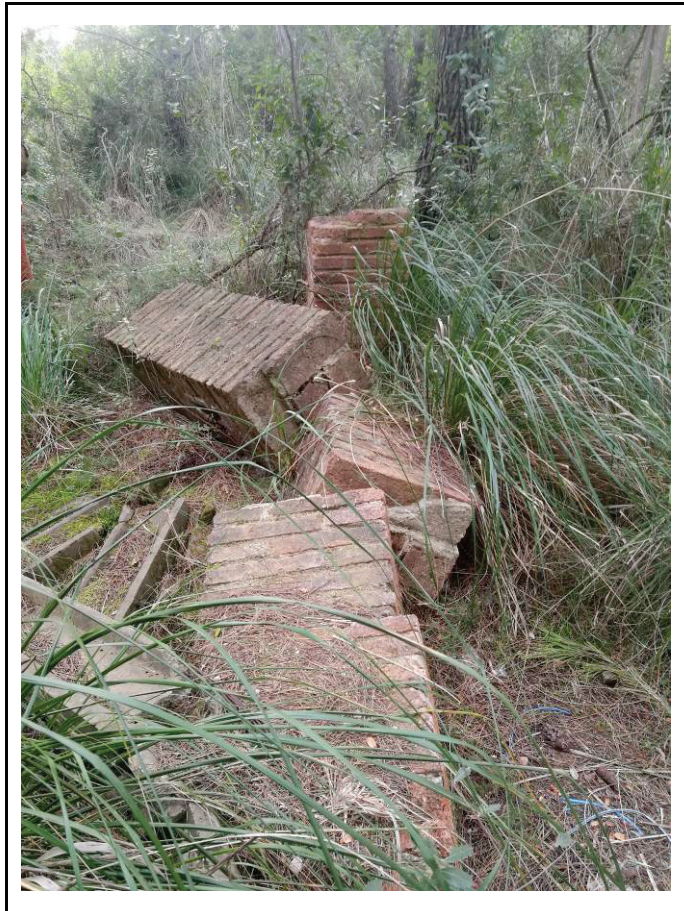
Foto 17. Pilastra caiguda de les naus d'assecat..
