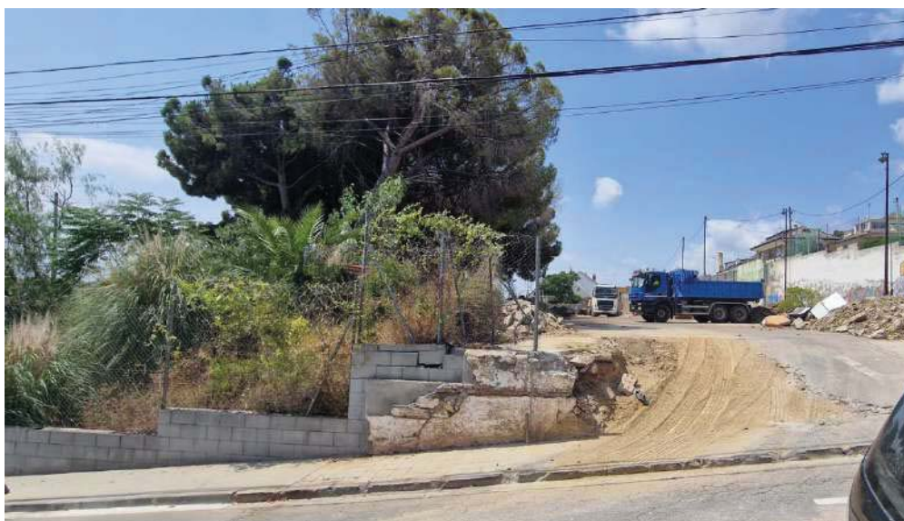
Vista des del Carrer de la Ginesta, s'observa l'estat de les pistes esportives.
