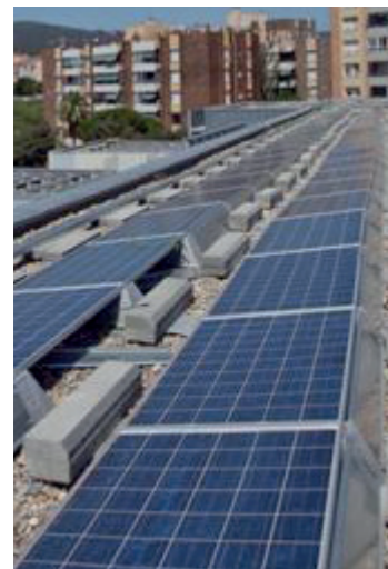
Placas solares en una escuela
