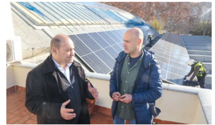
El alcalde visitó las obras de instalación en el mercado en diciembre
