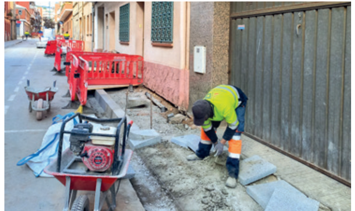
Operarios trabajan en las obras de la calle de la Muntanya, en diciembre
